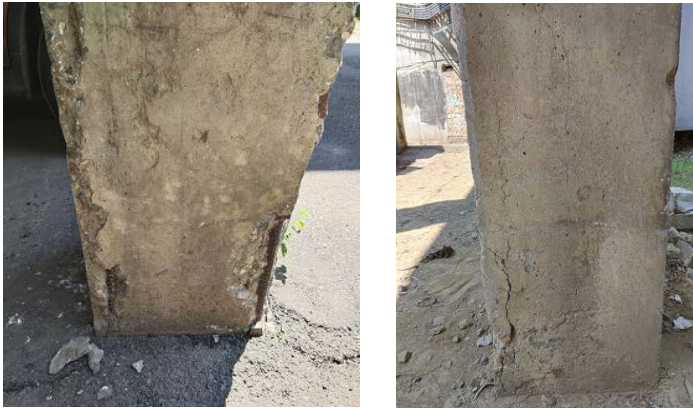
Рис. 1. Дефекти і пошкодження колон
