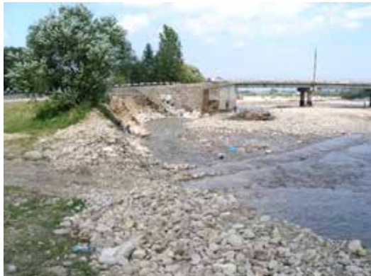
Рис. 5. Розмив лівого берега і полотна дороги перед мостом через р. Лімницю у смт Перегінське
