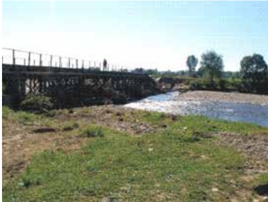
Рис. 4. Частково зруйнований міст через р. Чечву біля с. Довга Калуська
