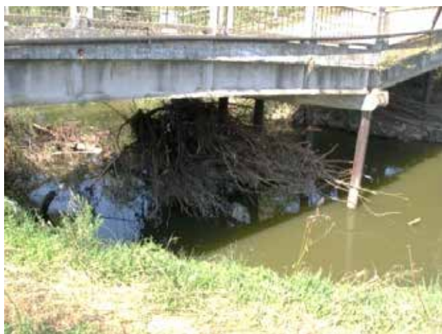
Рис. 8. Напівзруйнований міст на р. Болохівка біля с. Дубовиця
