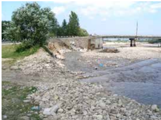
Рис. 5. Розмив лівого берега і полотна дороги перед мостом через р. Лімницю у смт Перегінське
